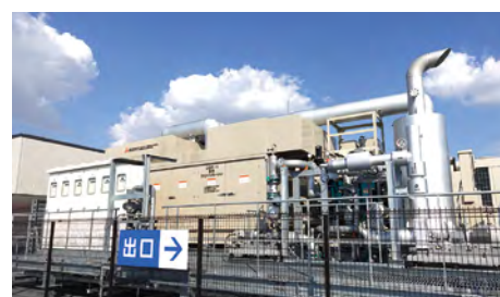
ガスエンジン・コージェネ(610kW×1台)
