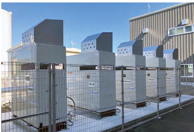
ガスエンジン・コージェネ(35kW×5台)
