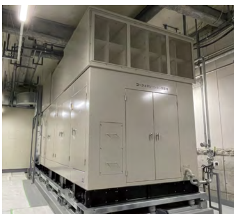
ガスエンジン・コージェネ (800kW×1台)
