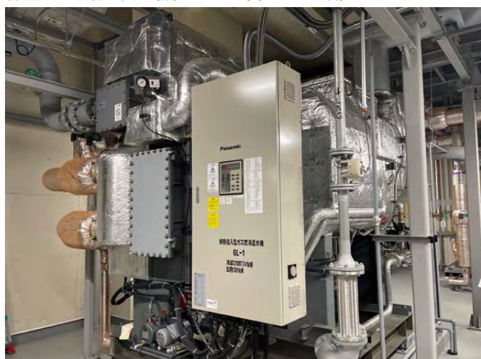
排熱投入型吸収式冷水機(ジェネリンク)(210RT×1台)
