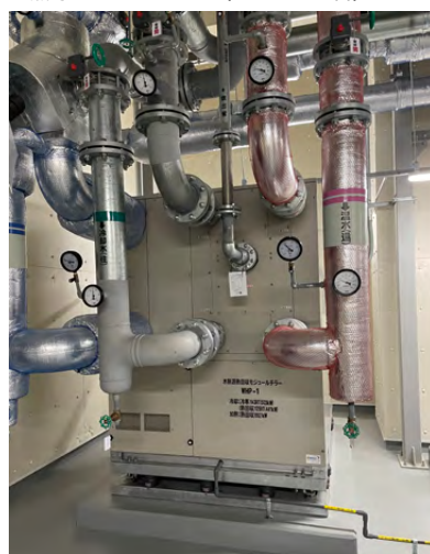
水熱源スクルーチラー(143RT×1台)
