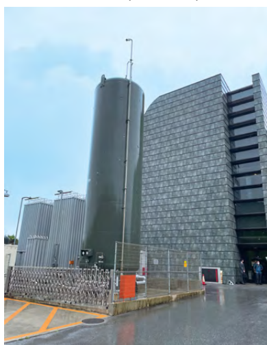
LNGサテライトタンク(60kL×1基)
