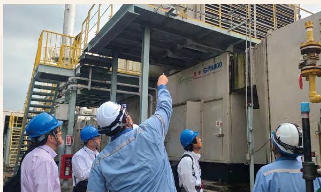
Yokohama Tire Manufacturing Thailandで稼働中のガスタービンコージェネ
