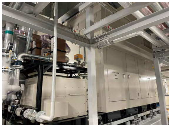
ガスエンジン・コージェネ (400kW×1台)
