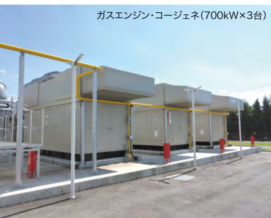
メーカ ヤンマーエネルギーシステム株式会社 モデル名 EP700G 燃料種別 天然ガス(LNG) 定格出力 700kW 台数 3台 効率 発電:41.8% 蒸気排熱回収:16.3% 温水排熱回収:15.7% その他 ブラックアウトスタート対応機種
