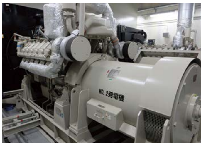
非常用自家発電装置
