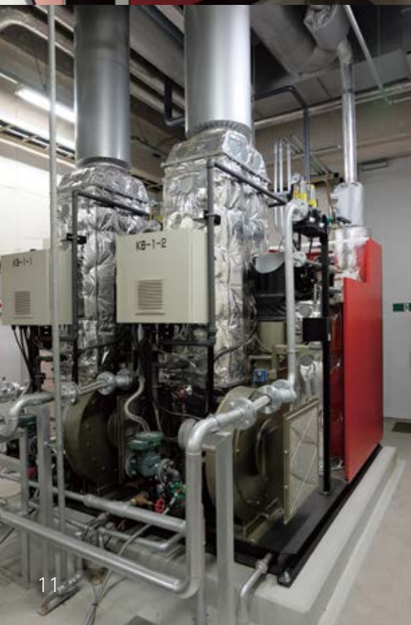
小型貫流ボイラ（下写真真）
