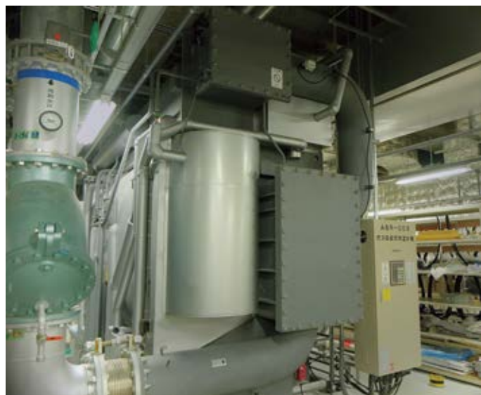
ガス吸収式冷温水発生機
