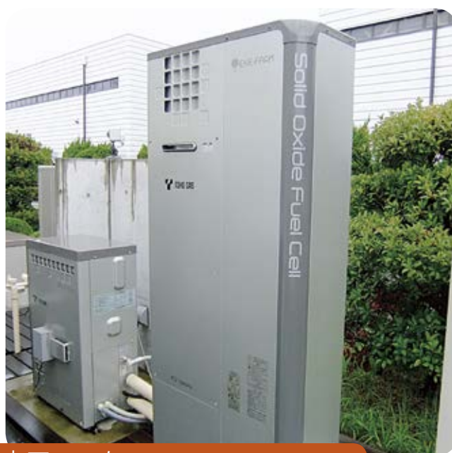
エネファーム (SOFCタイプ、アイシン精機製700W)
