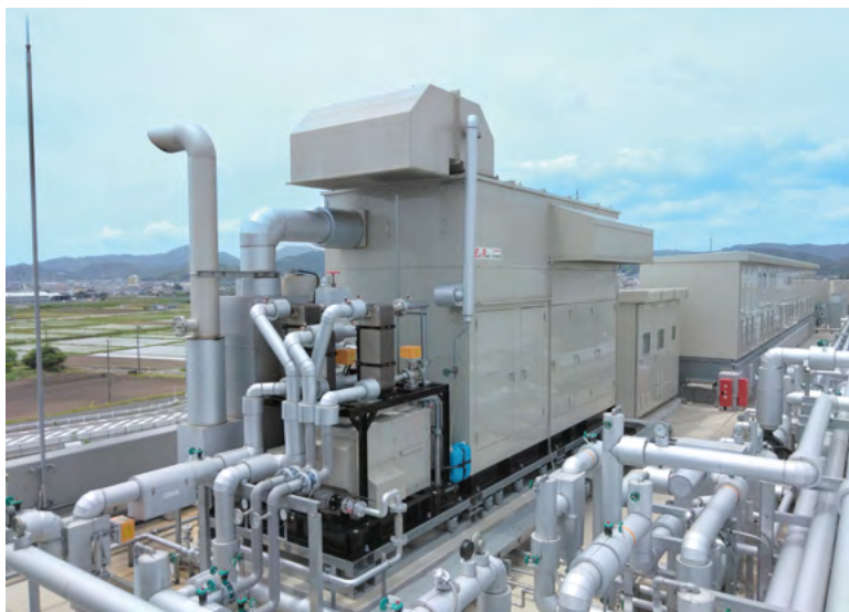
ガスエンジン・コージェネ(400kW)
