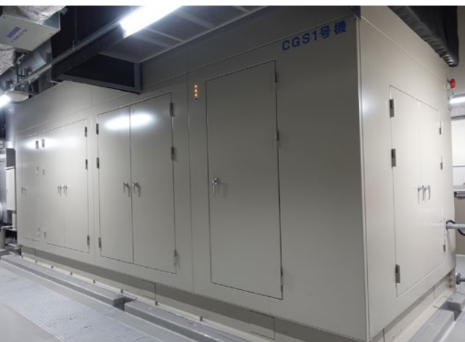
ガスエンジン・コージェネ(800kW×2台)
