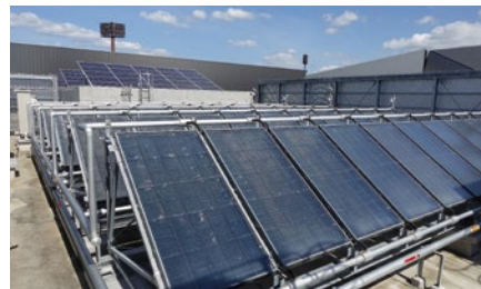
太陽光発電、太陽熱集熱パネル
