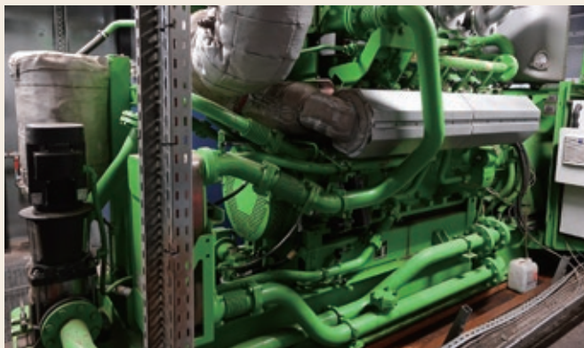
リエージュ空港に導入されたイエンパッハ製コージェネシステム
