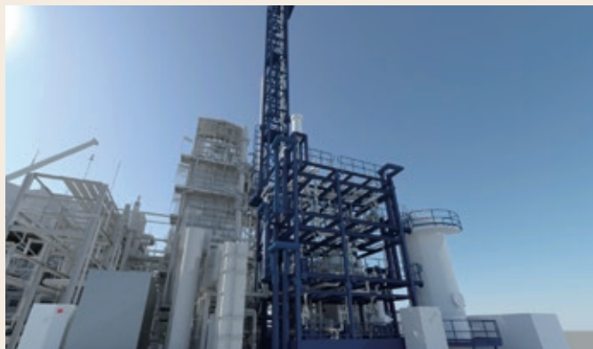
Air Liquideのメタンクラッキングプラント
