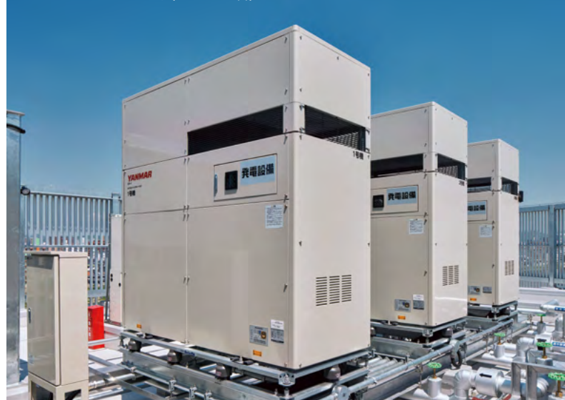
ガスエンジン・コージェネ(35kW×3台)
