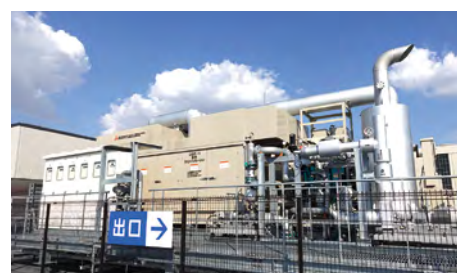
ガスエンジン・コージェネ(610kW×1台)
