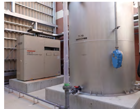
バイオガス発電システム (マイクロコージェネ25kW×1台)
