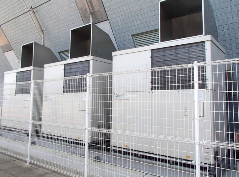
ガスエンジン・コージェネ (35kW×3台)
