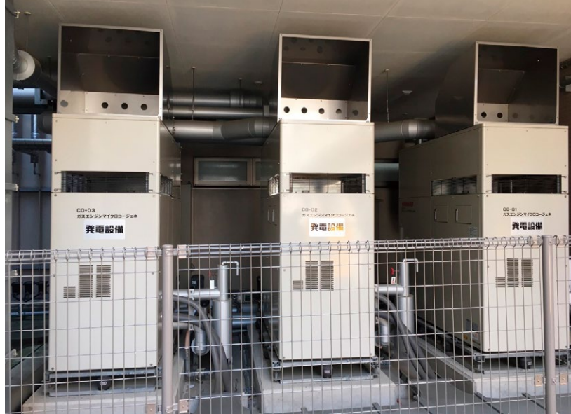
ガスエンジン・コージェネ(35kW×3台)
