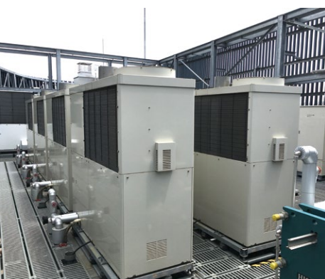
ガスエンジン・コージェネ (25kW×12台)
