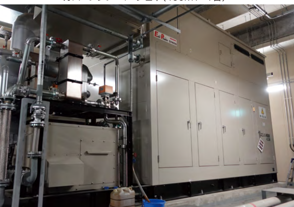
ガスエンジン・コージェネ(400kW×1台)
